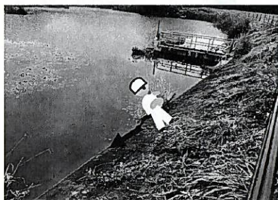
(ため池堤体の急傾斜)
